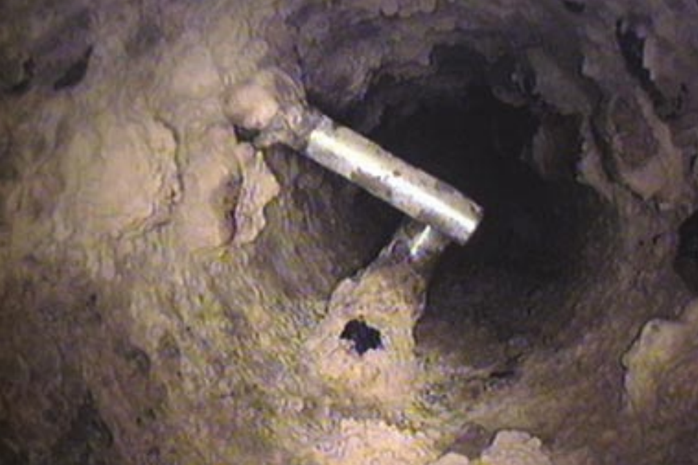
Temperaturfühler in einem Kühlkanal.
