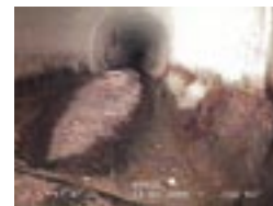
Durch Ablagerungen blockierte Rohrleitung
