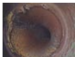
Kesselrohr mit Wasserstoffschädigung
