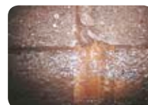
Wassereinbruch im Bereich einer Schweißnaht
